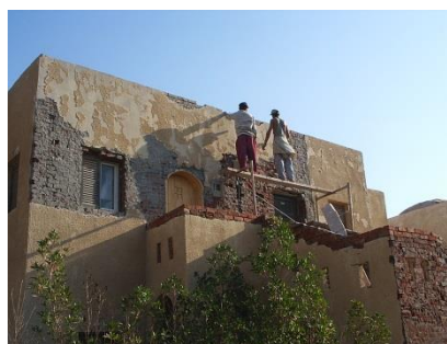
Verputzerarbeit mit unzureichenden Arbeitssicherheitseinrichtungen → Unfallgefahr
