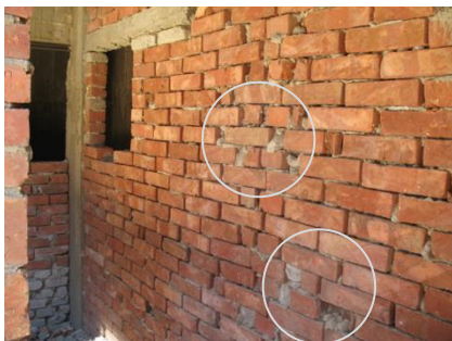
Mängel am Mauerwerksverbund durch unkorrekte Ausführung → Einsturzgefahr
